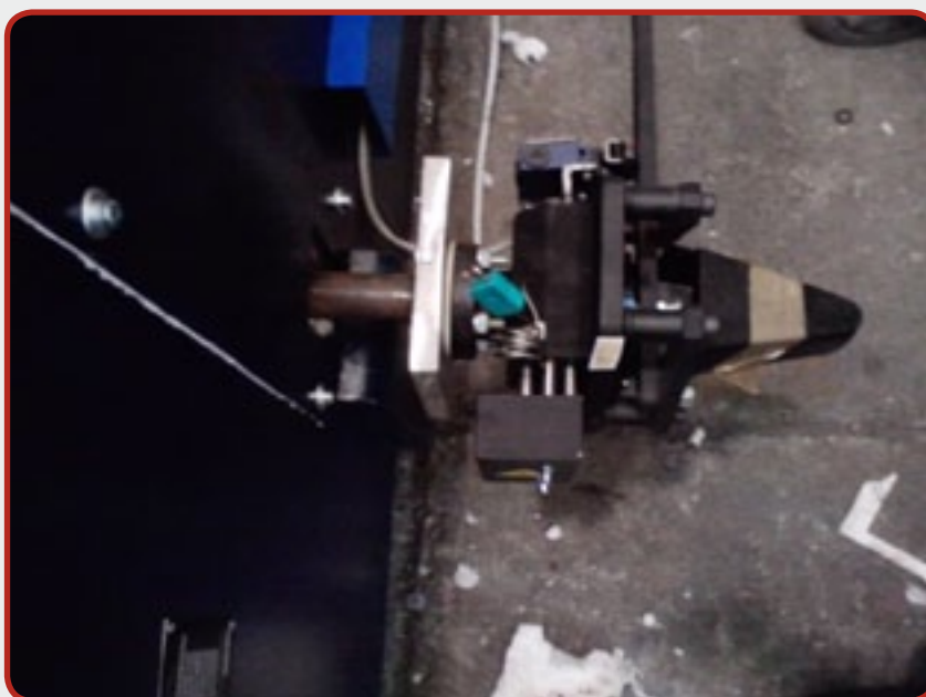
12. Vanne de transfert des liquides motorisée avec crayons chauffant.
