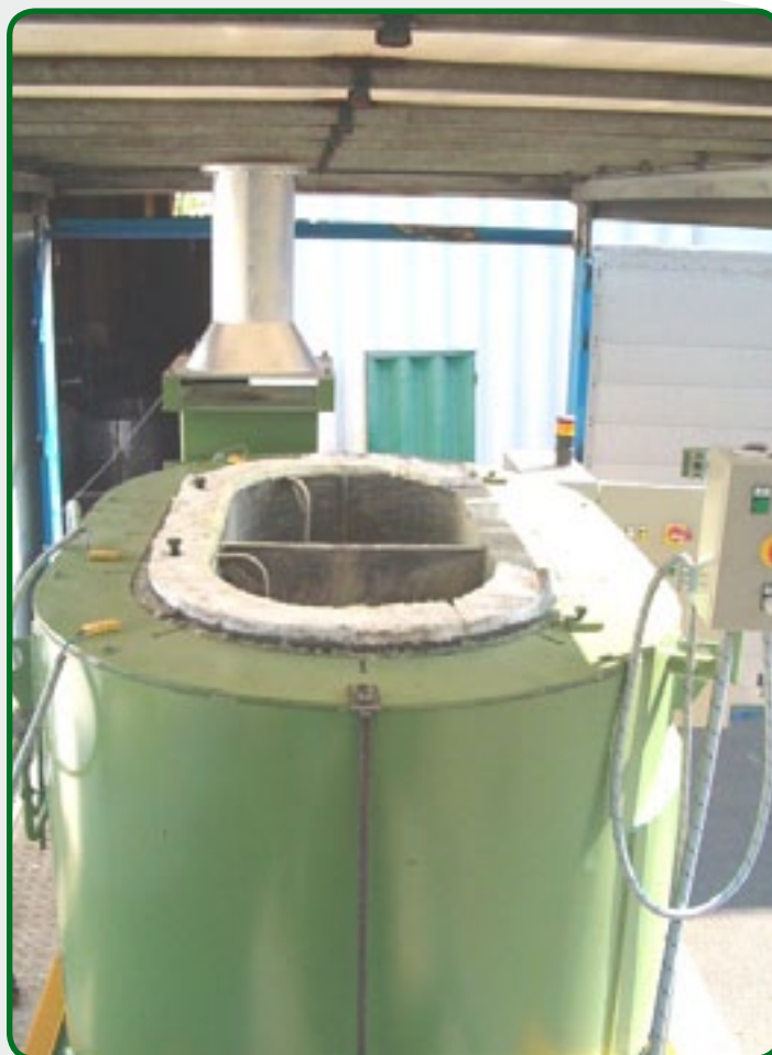
9. Horno doble cámara para mg, capacidad 600 kg.
