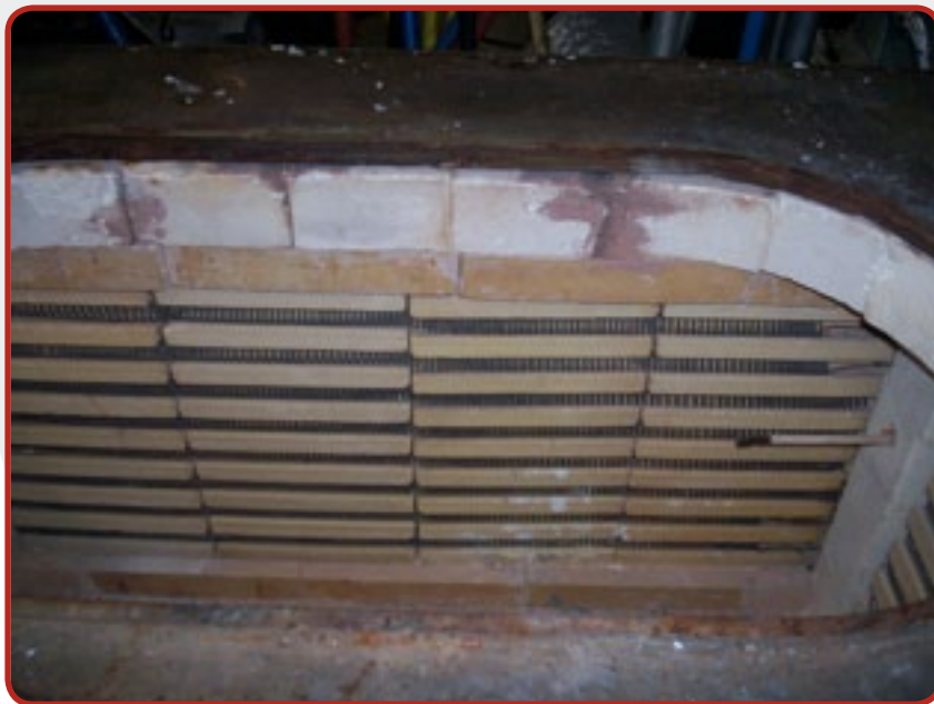
14. Elektrische Heizspiralen in keramischen Tragsteinen.
